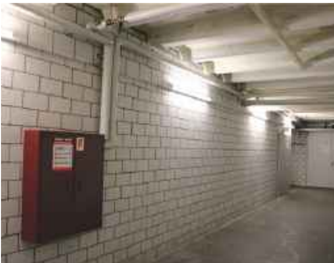
Hier im Anwendungsbeispiel für Tiefgaragenbeleuchtungen.
