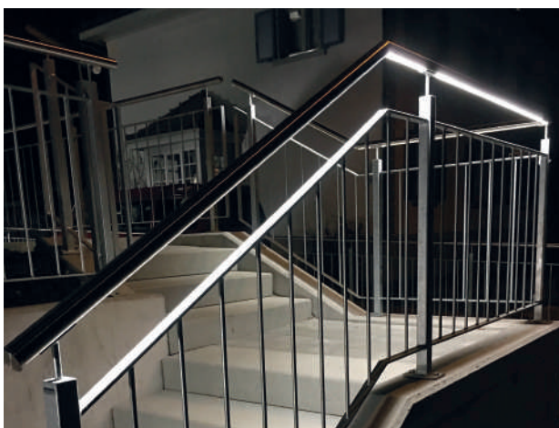
Treppengeländerbeleuchtung im Aussenbereich. (Bilder: Unex Dakota).
